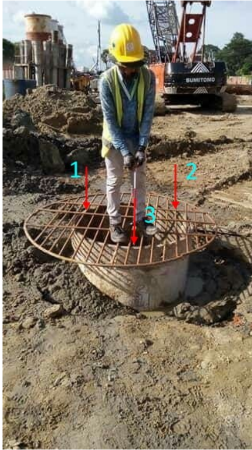
Center circle (3 points) การประยุกต์ใช้งานในการหาตำแหน่งปักเคสสิ่งเสาเข็ม
